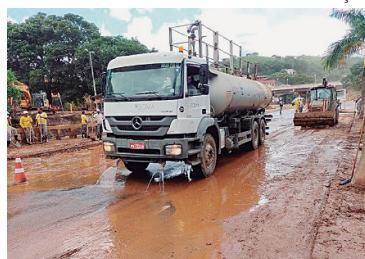
Caminhão pipa enviado pela AngloGold Ashanti para Sabará_Cred
